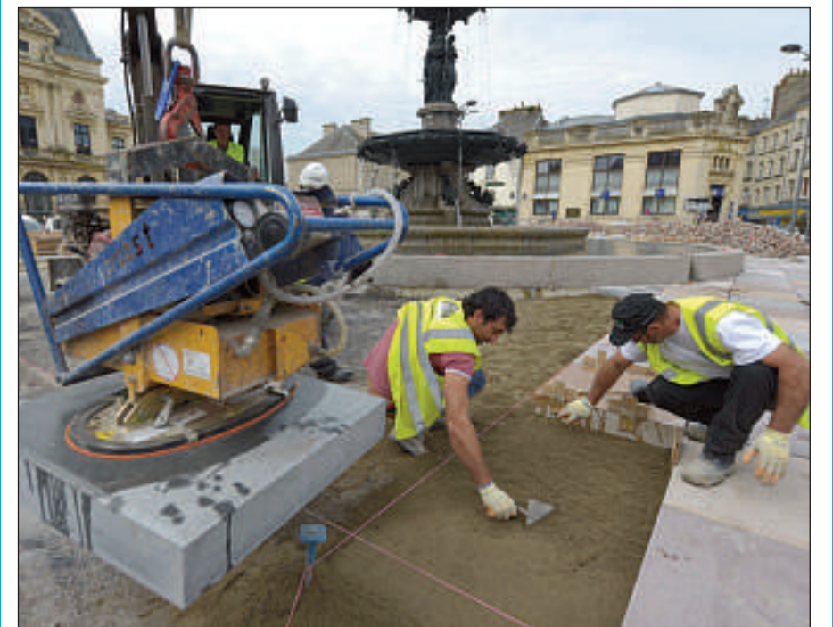
Les dalles de granit sont savamment posées par des ouvriers d'une entreprise de l'Oise.
